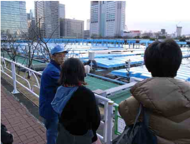
図5 下水処理施設（反応槽）近景
