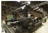
大型のコンプレッサー
